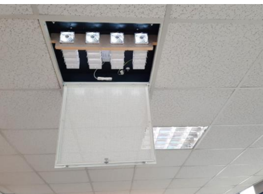
SANIXBOX INSERITO IN CONTROSOFFITTO (60x60cm)
